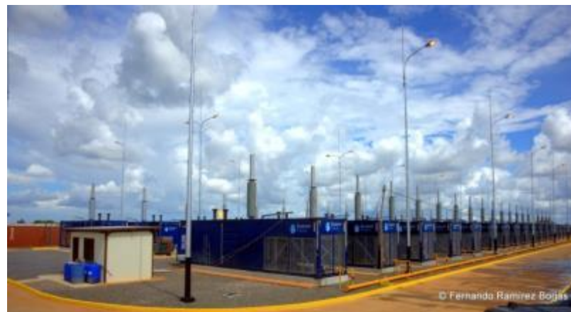
Centrale APG 28 MWe (Vénézuéla)
