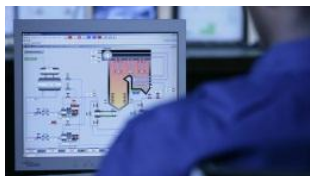
SPPA-T3000 Système de Contrôle
