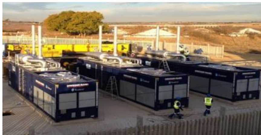
Site PCEC au biogaz, 3 x SFGM 240 (Mexico)
