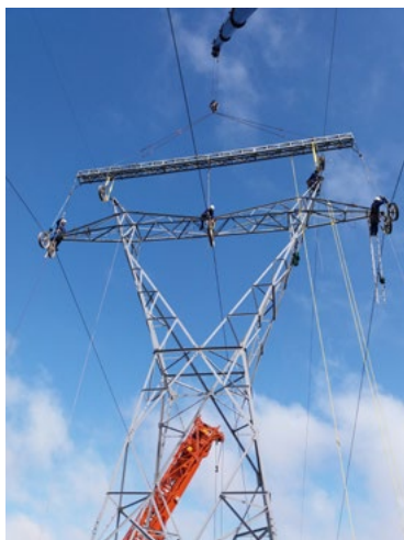
Stretches of the Belesar – Mesón line.
